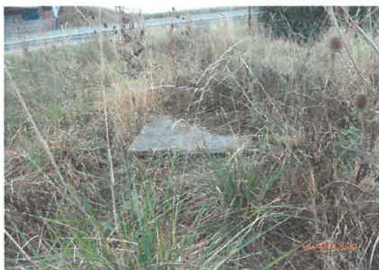
Regard avec limiteur de débit
